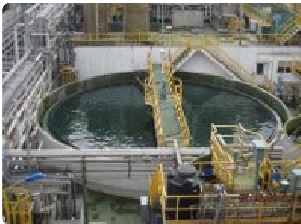
混凝沉澱處理
