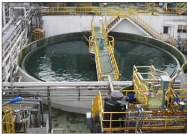
混凝沉澱處理
