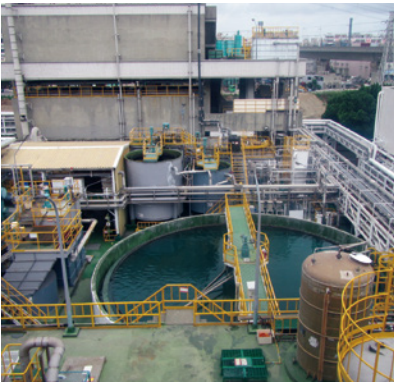
低濃度廢水處理系統
