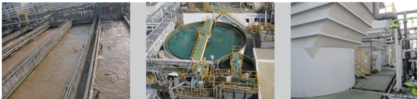
圖 3.17 廢水處理設備照片 (生物處理、混凝沉澱處理、化學反應處理)
