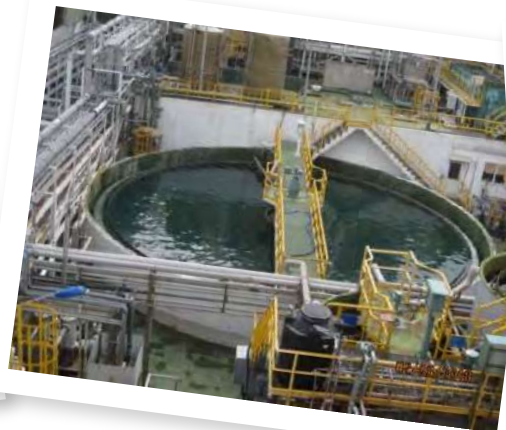
▲ 混凝沉澱處理
