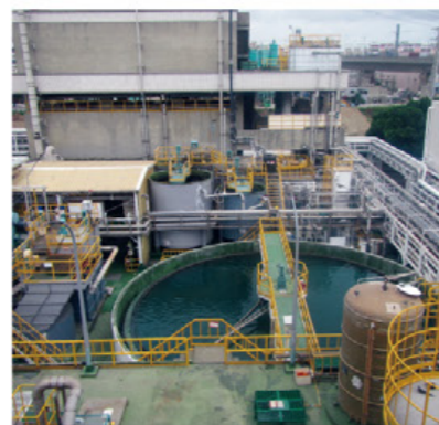
低濃度廢水處理系統
